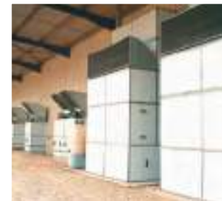
Ventilation répondant aux normes sanitaires et environnementales
