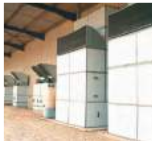
Ventilation répondant aux normes sanitaires et environnementales
