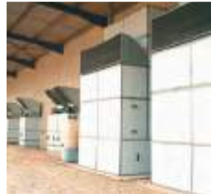
Ventilation répondant aux normes sanitaires et environnementales
