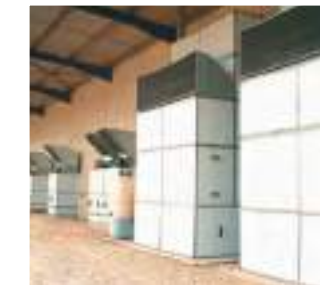
Ventilation répondant aux normes sanitaires et environnementales
